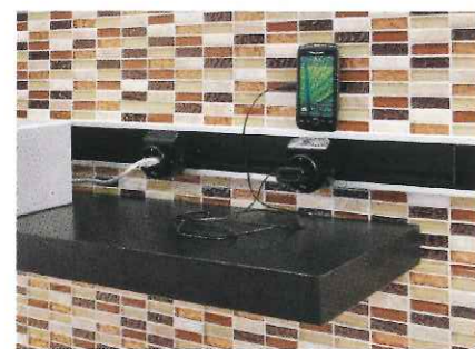
Entlang der Stromschiene an der Mosaikwand lassen sich Steckdosen variabel platzieren – immer dort, wo sie gerade gebraucht werden.
